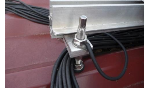
Sicherheitsvorrichtung überbrückt (DC-Trennschalter)
